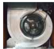
Grupo de transmisión con ventilador centrifugo en acero galvanizado.
